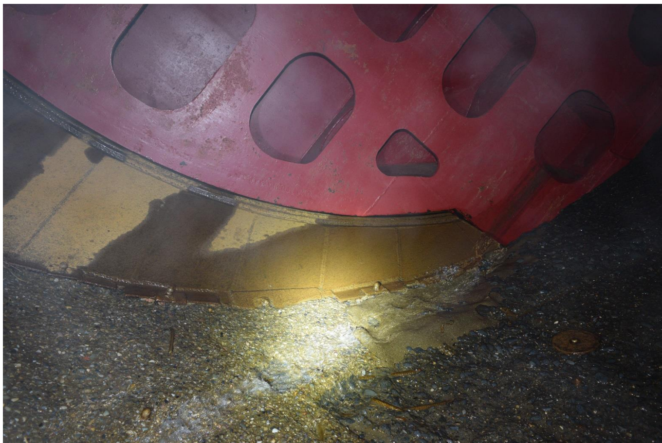
Фото 3. Состояние АКЗ обтекателя шандоры
