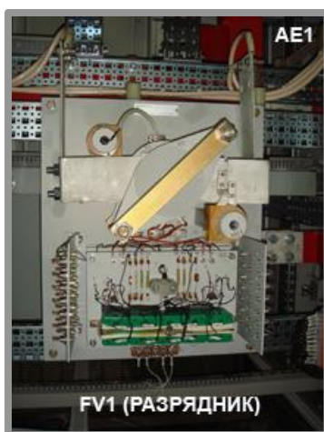
рис. 1.4. Устройство защиты ротора от перенапряжений (УЗП) типа УЗП-38.
