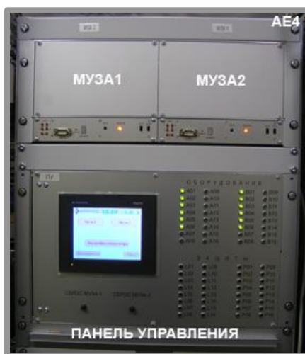
рис. 1.11. Панель управления и защит.
