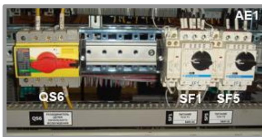
рис. 1.7. Коммутационная аппаратура релейного шкафа ШСВ.
